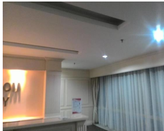
Figure 2 : No Toilet Signage
